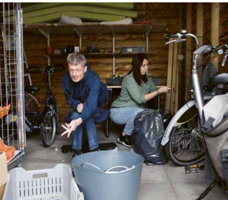
Maaike helpt Christiaan met sloopwerk in de schuur: 'Een idee van Irma.'
